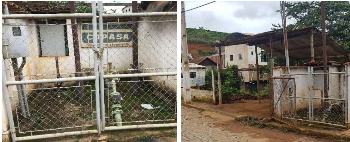
Figura 2: Ponto de captação 1, localizada no núcleo urbano de Padre Fialho.
