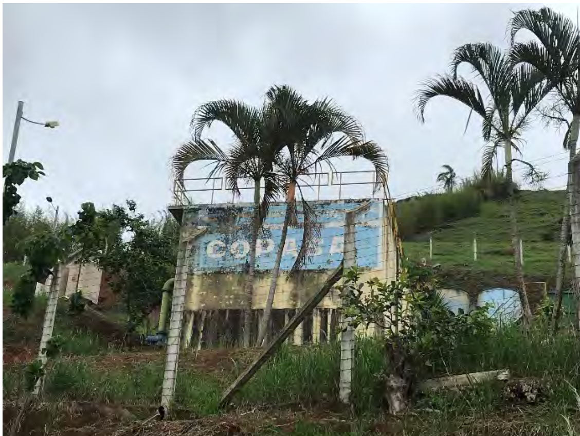
Figura 7: Estação de tratamento de água da sede urbana de Matipó.
