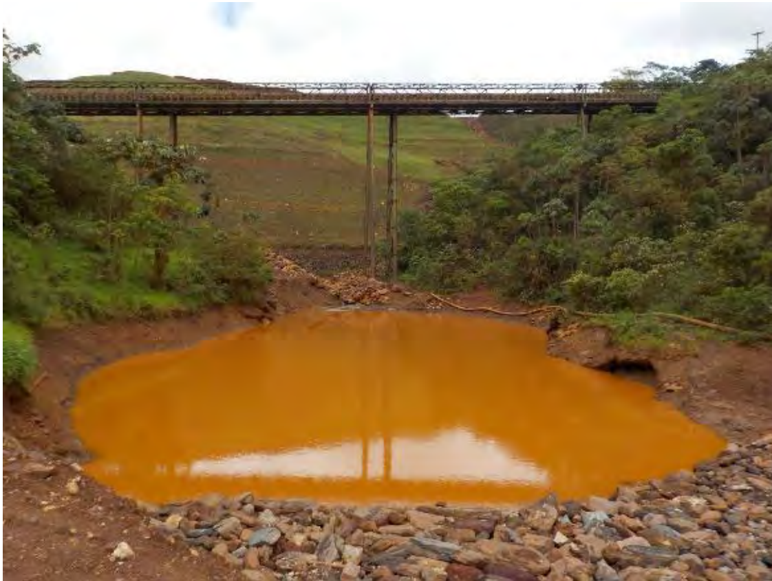
Figura 6: Vista do reservatório do Dique B2 de jusante para montante (Fonte: G103093-G-1RT001_R-01)
