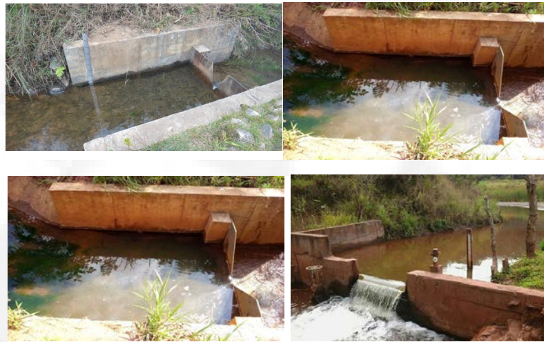
Figura 6. Medidores de vazão. Barragem Casa de Pedra.
