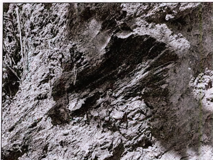
Foto 61 – Detalhe para o material de fundação observado na ombreira esquerda, onde pode se observar que a foliação mergulha em direção favorável à estabilidade da estrutura.
