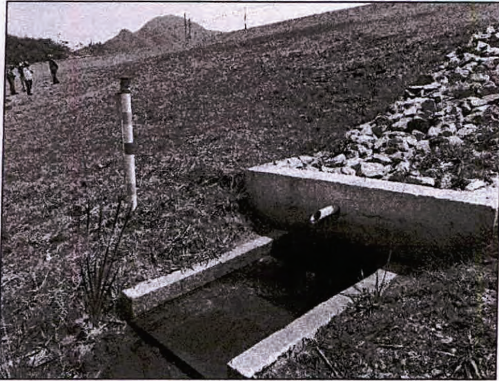
Foto 36 – Saída 02 do dreno de fundo da barragem.
