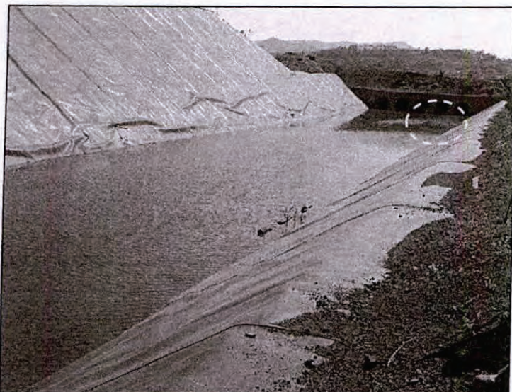
Foto 15 – Vista do canal de aproximação. Observar alguns pontos de sedimentos acumulados (próximo ao desembocamento, já com formação de vegetação) e tubulações inativas na calha.
