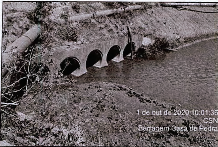
Foto 14 – Emboque dos bueiros sob o acesso, com sedimentos acumulados a montante e tubulação obstruindo parcialmente um dos bueiros.
