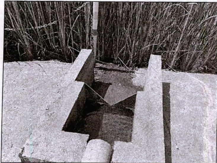
Foto 35 – Medidor de vazão MV-B4-01 localizado na ombreira direita da estrutura.
