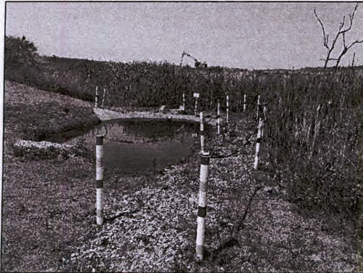
Foto 37 – Saída 03 do dreno de fundo da barragem.
