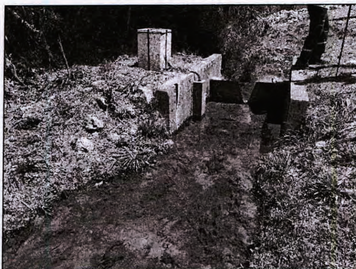
Foto 69 – Medidor de vazão em chapa triangular na saída do dreno de fundo.
