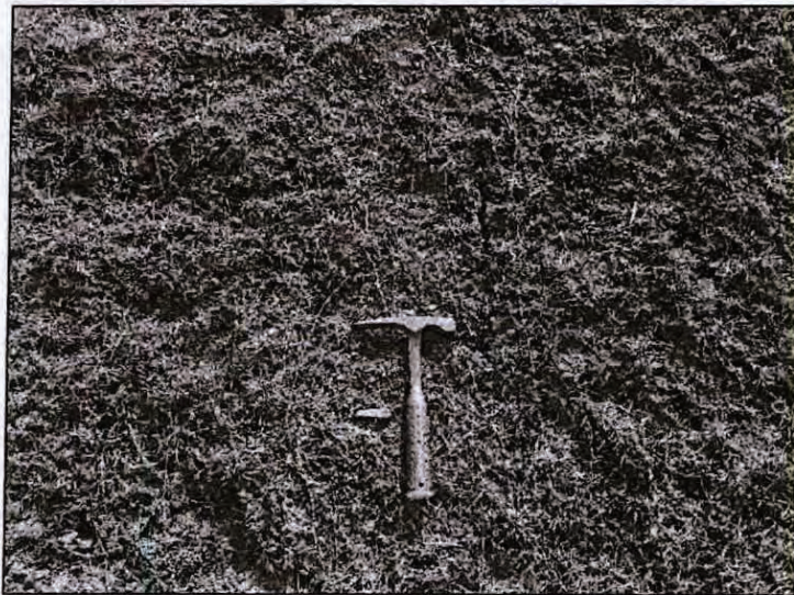
Foto 11 – Presença de trinca no talude de jusante, próximo à ombreira direita.
