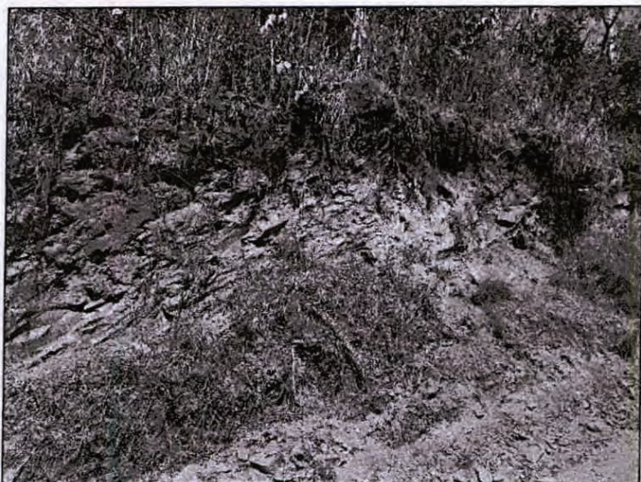
Foto 7 – Saprolito de filito em um corte de acesso para o dreno de fundo da estrutura, ombreira direita.
