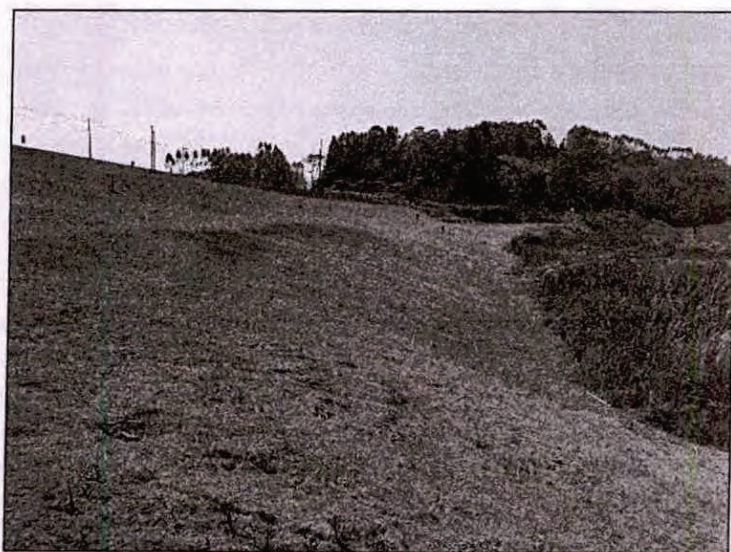
Foto 32 – Porção do talude da berma de reforço com cobertura vegetal com coloração diferenciada.
