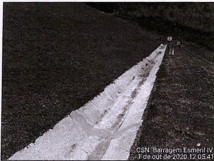
Foto 75 – Canaleta de drenagem com trinca tratada.
