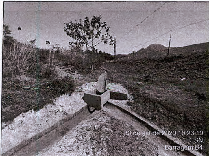
Foto 45 – Canaletas do sistema de drenagem superficial.
