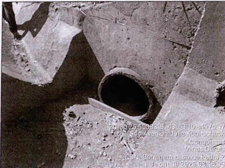
Foto 22 – Caixa de passagem com assoreamento e pedaço de madeira no emboque do bueiro. Barragem Casa de Pedra.
